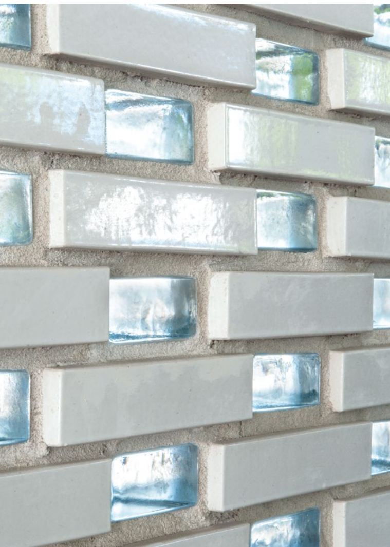
L'association de la brique en terre cuite et de la brique de verre crée un intéressant jeu de lumière et d'ombre.
