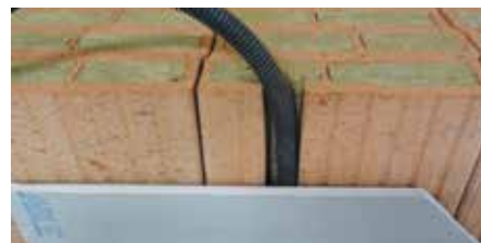
Finition plaque de plâtre collée par plots en mortier type MAP (Mortier Adhésif Placo)
