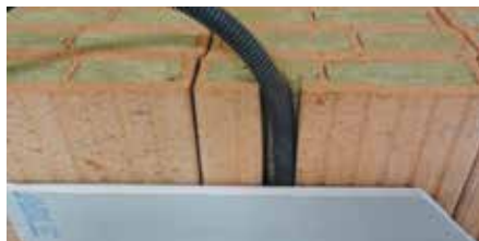
Finition plaque de plâtre collée par plots en mortier type MAP (Mortier Adhésif Placo)
